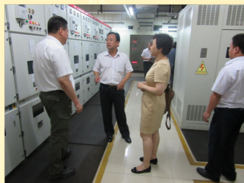
评估专家现场查看配电室
